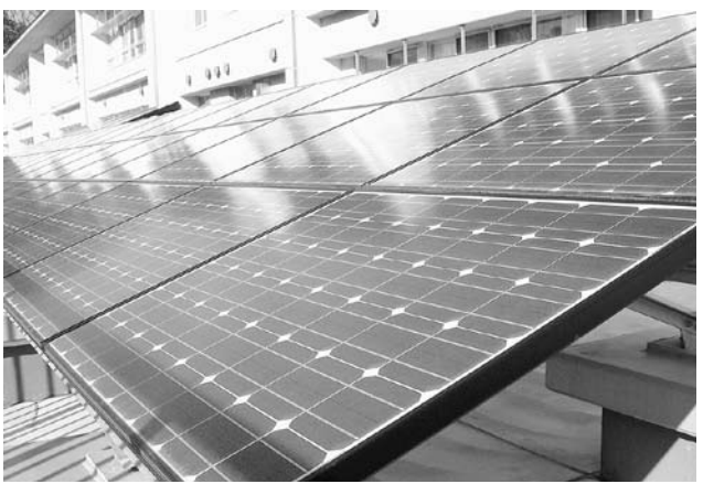
桜井小学校屋上に設置されている太陽光発電パネル
