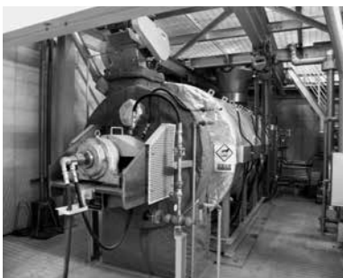
取り付けられたダイオキシン除去装置の一部
