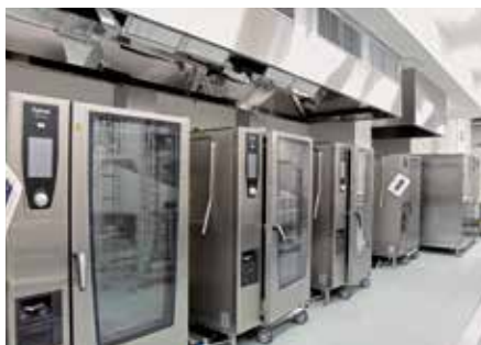
揚げ物・焼物・蒸し物調理室 フライヤー1台、スチームコンベクションオープン4台で調理をします。
