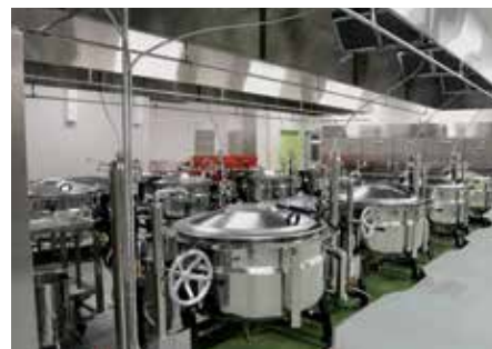
煮炊き調理室 蒸気回転釜10台とスチームコンベクションオープン1台で炒め物や汁物などを作ります。
