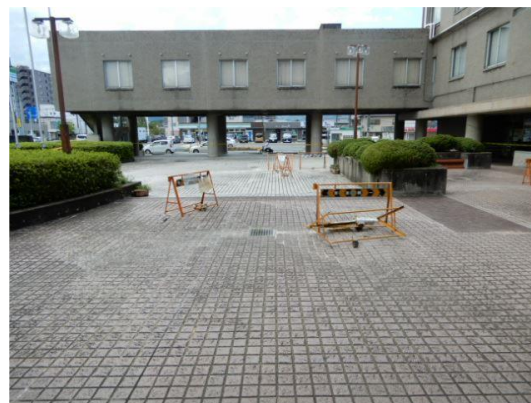
外構床タイル破損
