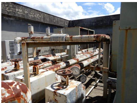
改修前の不使用機器・配管が放置
