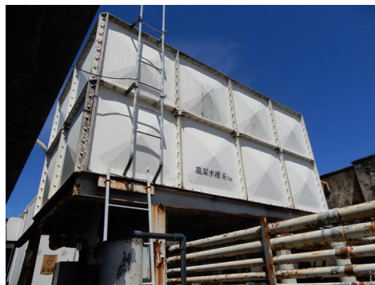
高架水槽（要交換）
