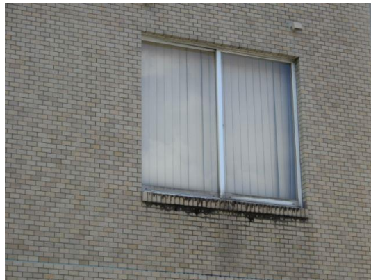
外壁タイルの浮き・汚れ
