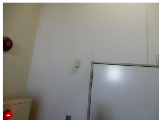
階段室のひび割れ
