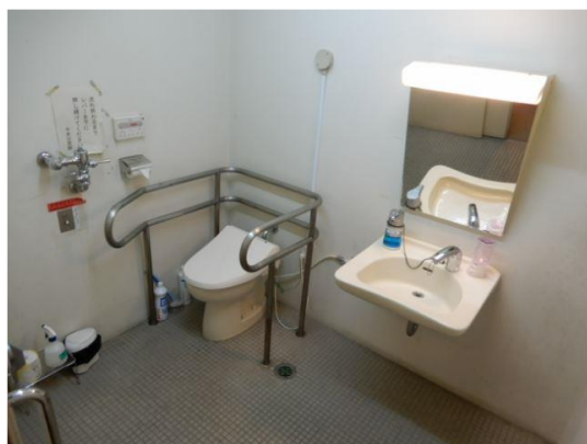
身障者トイレの老朽化
