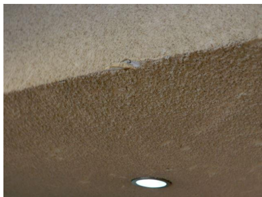
ホール天井の膨れ
