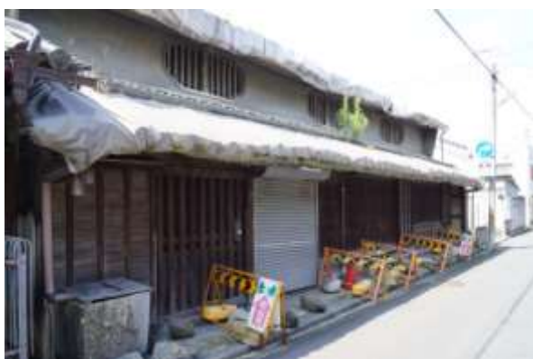
老朽化し空き家となった町家
