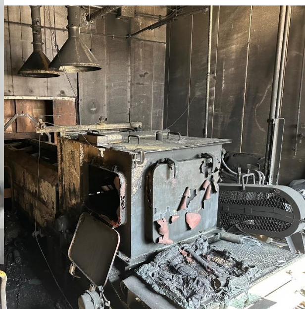
損傷した設備
