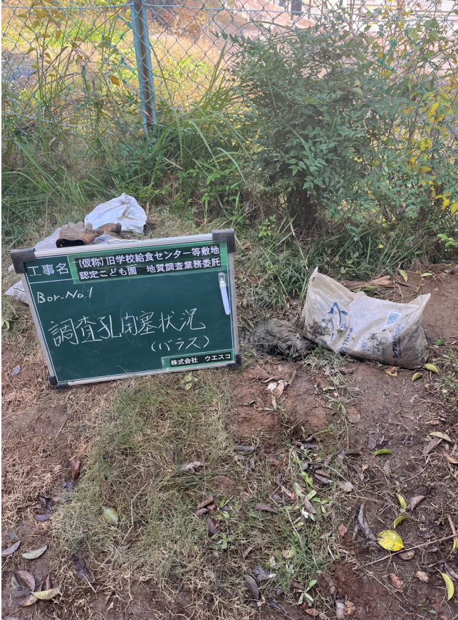
調査孔閉塞状況 (バラス)
