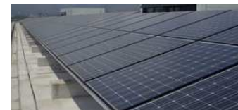
図 太陽光パネル
