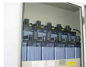
図 盤内収納蓄電池
