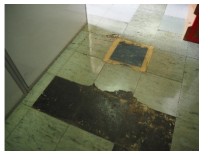
■床面のタイルの劣化
