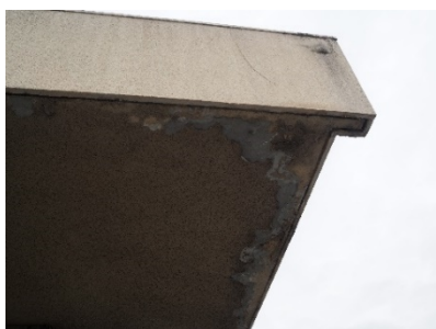
■外壁のひび割れ
