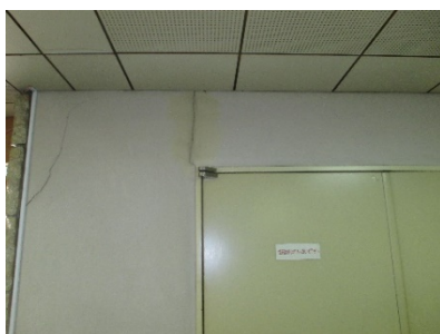
■内壁のひび割れ
