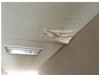
■天井の雨漏り跡
